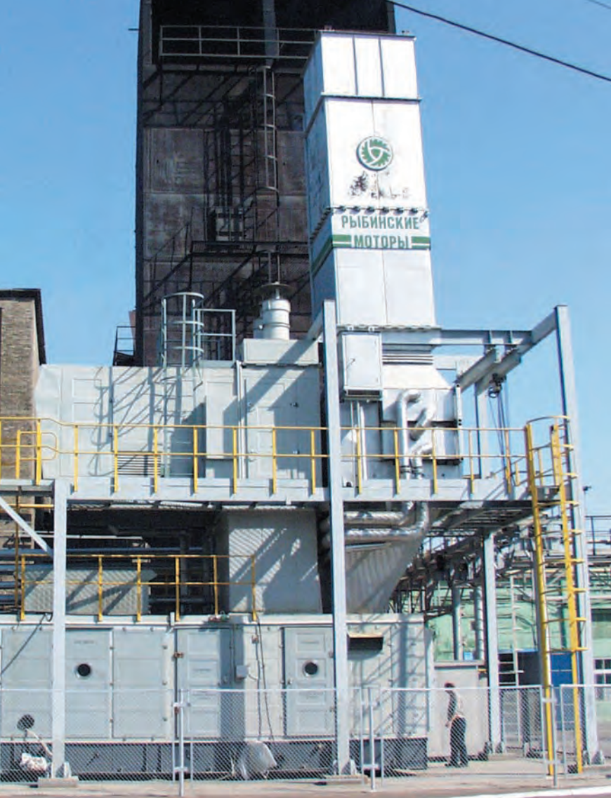
Теплоэлектростанция ТЭС-2, на территории объединения «Рыбинские моторы»
